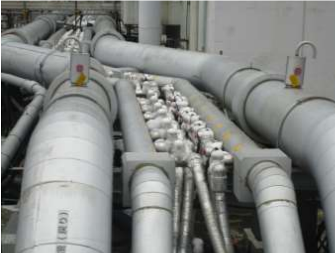
図 2. 凍土壁ブライン配管。縦方向のブランチの天辺に霜が付いている。
