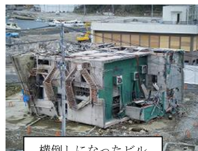
横倒しになったビル
