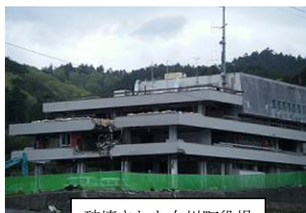
破壊された女川町役場
